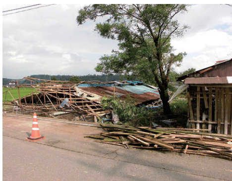
平成27年台風第15号の被災現場（熊本県山鹿市） （山鹿市提供）
